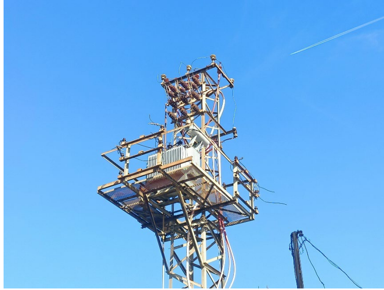
Resim 6.1-1 Şebeke Transformator Görseli
