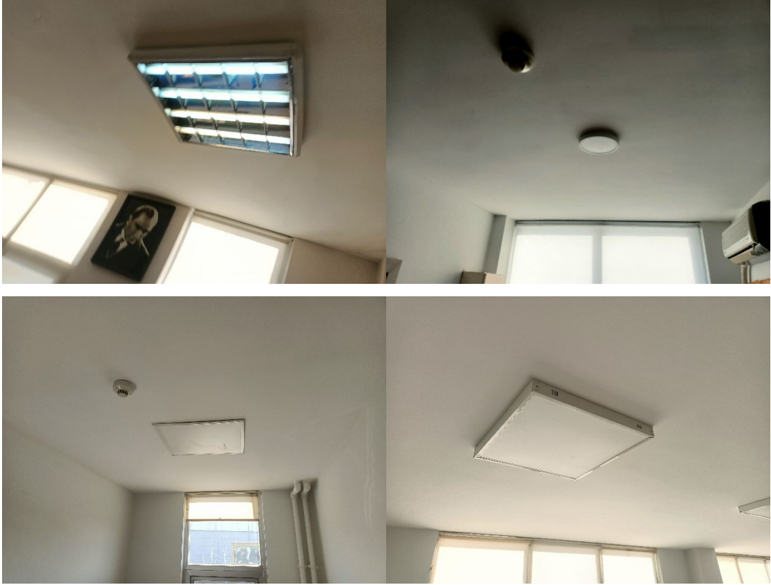
Resim 6.6-1 Tesisteki Aydınlatma Armatürleri Örnekleri
