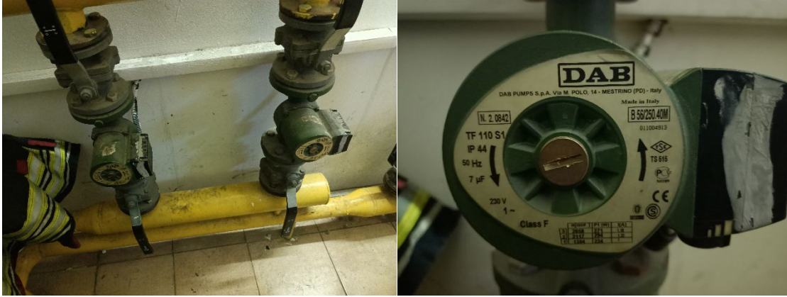
Resim 6.5-1 Binadaki Elektrik Motorları
