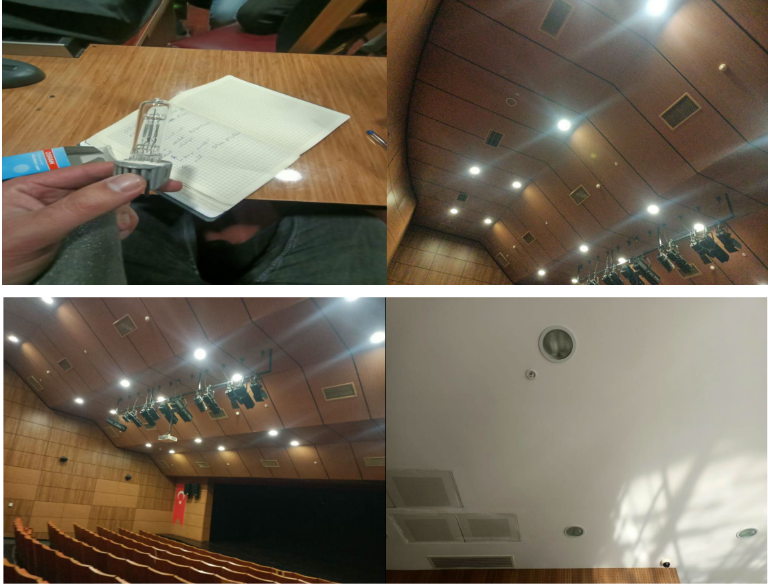
Resim 6.6-1 Tesisteki Aydınlatma Armatürleri Örnekleri
