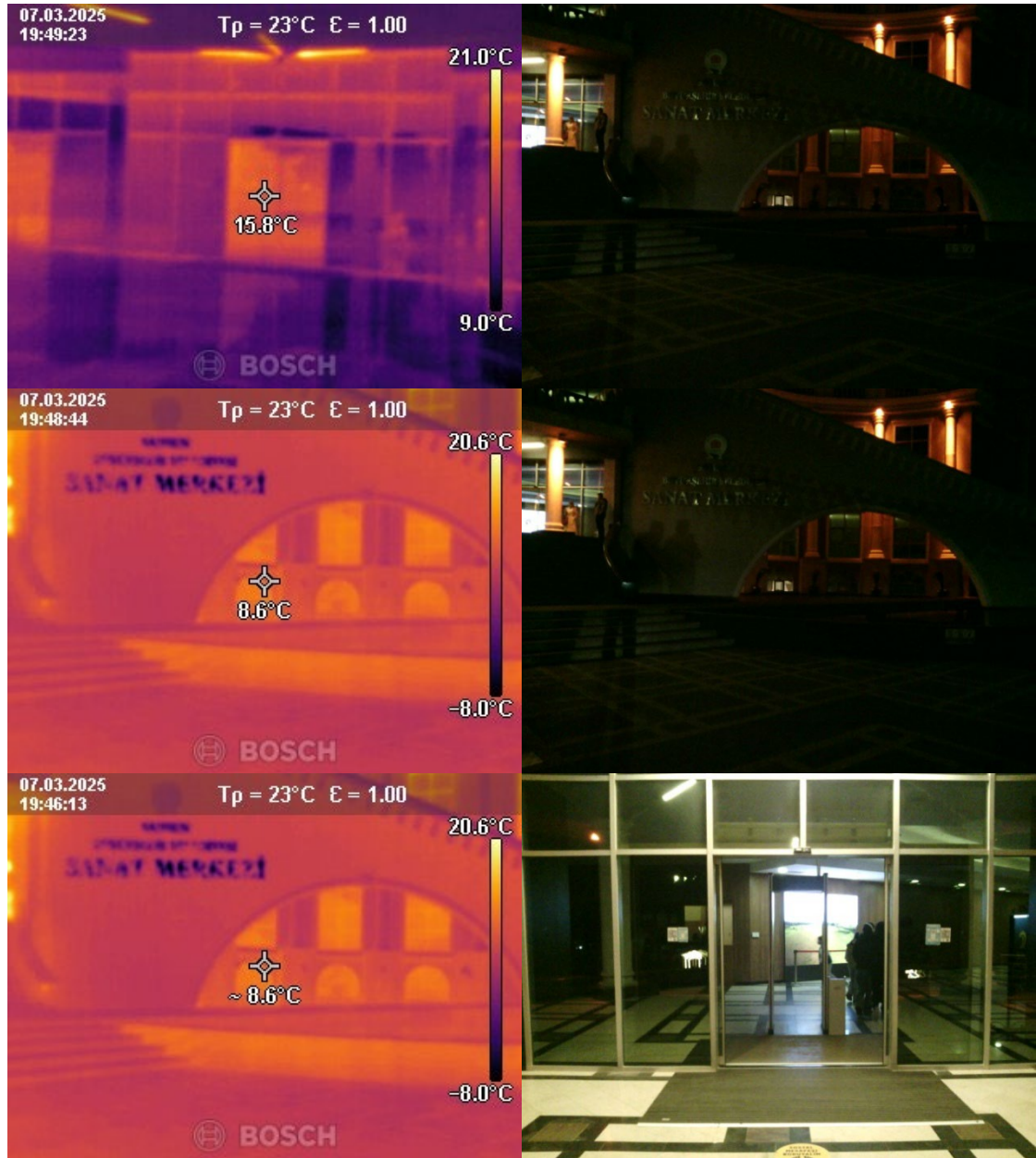
Resim 4.1-2 Bina Termal Görüntüsü
