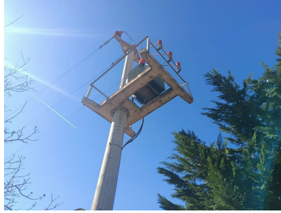
Resim 6.1-1 Şebeke Transformatör Görseli
