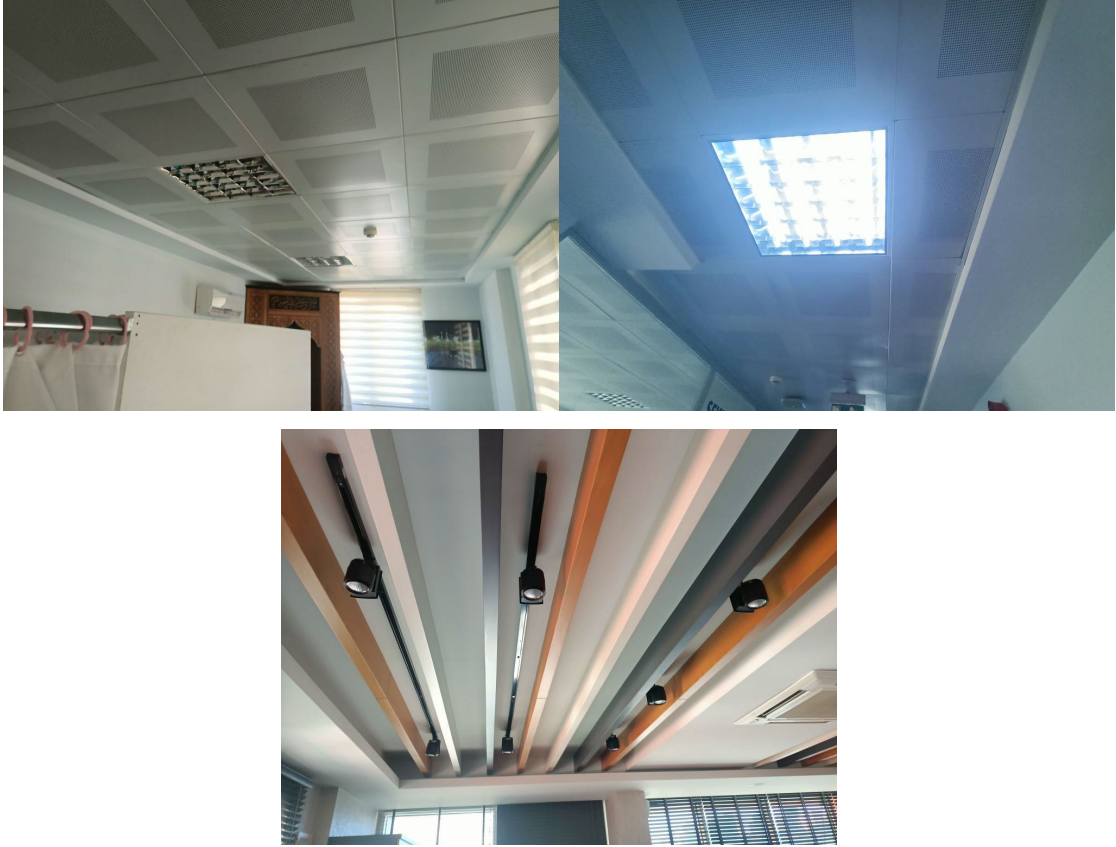
Resim 6.6-1 Tesisteki Aydınlatma Armatürleri Örnekleri
