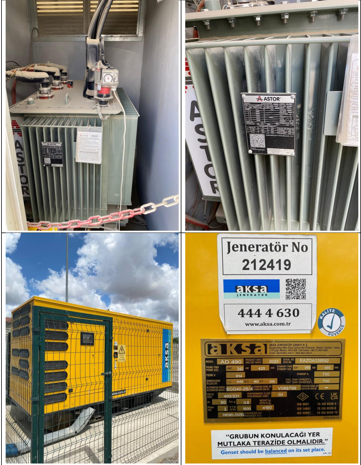
Resim 13-1 Trafo ve Jeneratör Görseli
