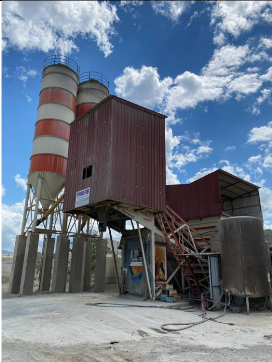
Beton Santrali Makinesi
